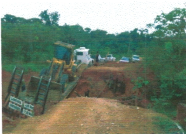
RESTO DA PONTE QUEIMADA
