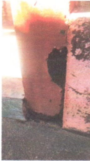
Foto 08: base de pilar em madeira já deteriorada
