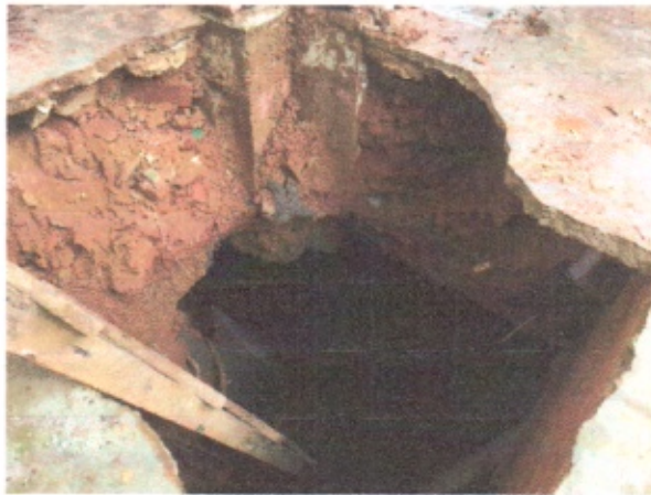
Foto 03: desmoronamento de fossa destivada
