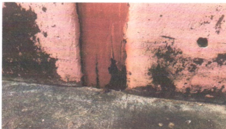
Foto 11: base de pilar em madeira já deteriorada
