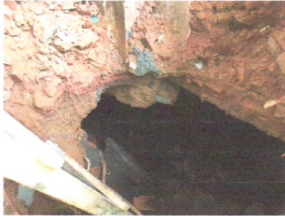
Foto 05: desmoronamento de fossa desativada, vista da fundação que ficou suspensa
