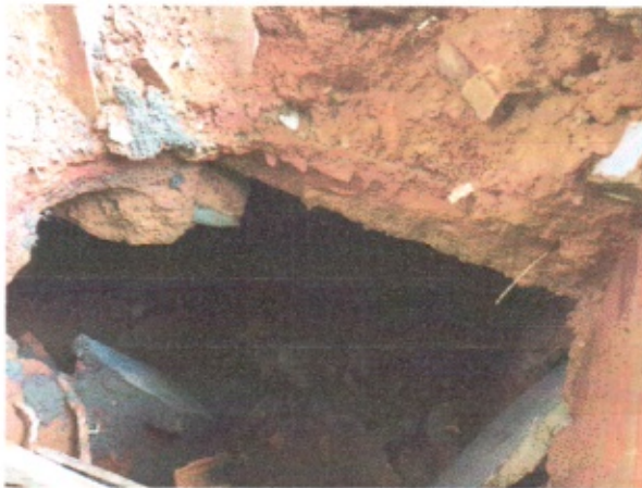
Foto 04: desmoronamento de fossa destivada
