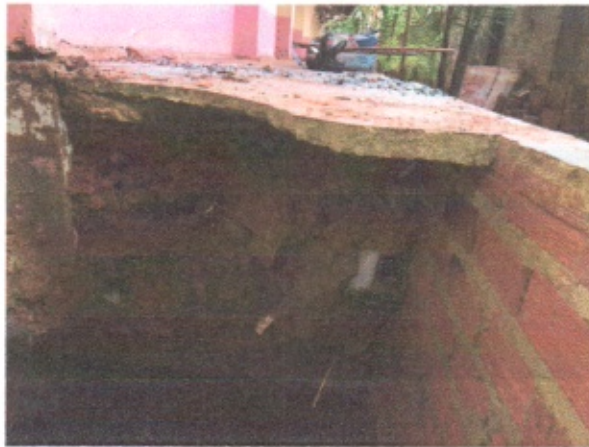
Foto 06: desmoronamento de fossa desativada, vista do aterro e tampa de fossa
