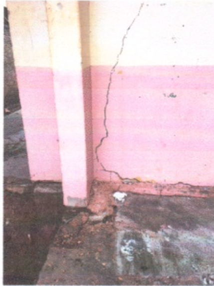
Foto 01: fissura e descolamento de pilar
