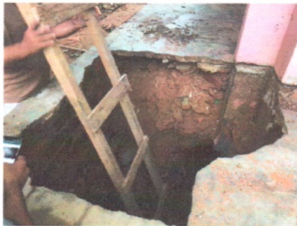
Foto 02: desmoronamento de fossa destivada
