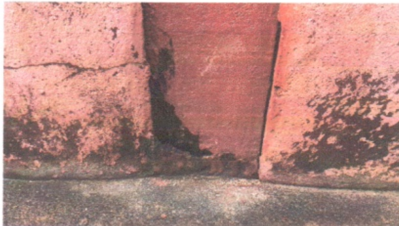
Foto 09: base de pilar em madeira já deteriorada
