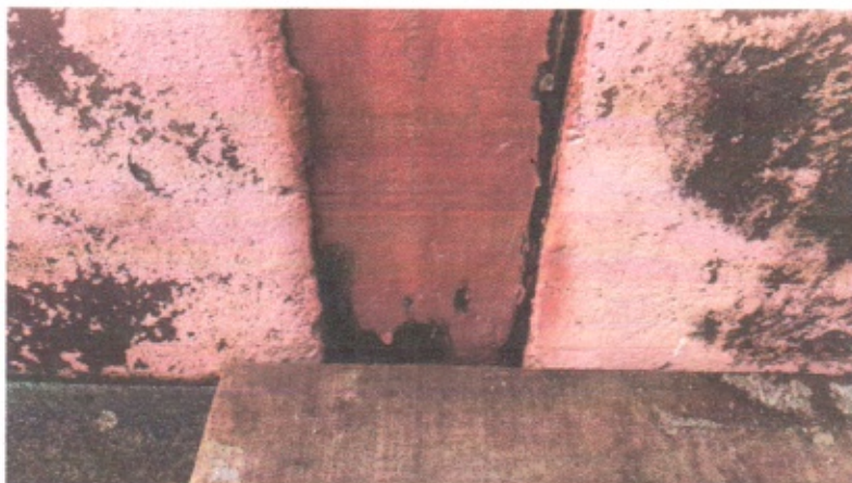
Foto 10: base de pilar em madeira já deteriorada
